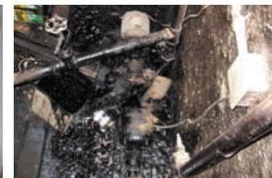
FOTO 5.14 Vazamento de óleo em um sistema de tubulações que alimentava uma caldeira
