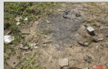
FOTO 10 Mancha escura no solo, causada pela queima de fios no local.
