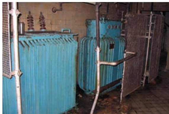
FOTO 5.15 Transformadores abandonados com o piso contíguo manchado de óleo
