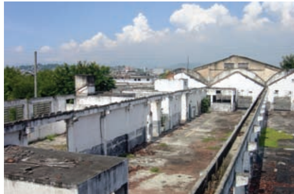
FOTO 5.10 Galpão industrial em ruínas com suas bases para instalação de equipamentos
