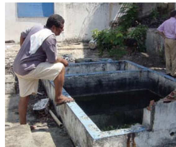
FOTO 5.18 Estação de tratamento de efluentes de galvanoplastia com piso danificado e manchas no chão
