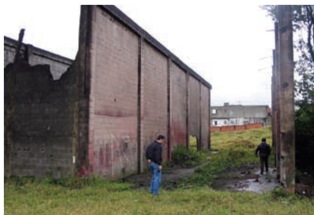
FOTO 5.9 Terreno Livre com parede de ruína industrial, bastante deteriorada
