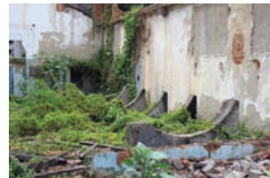
FOTO 5.11 Base de tanque em indústria abandonada
